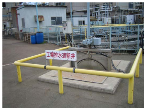
工場排水遮断弁
