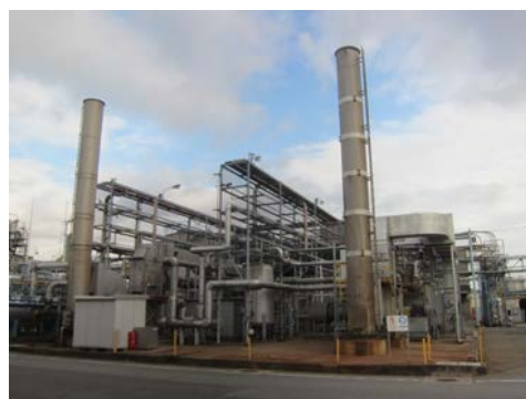
ボイラー設備
