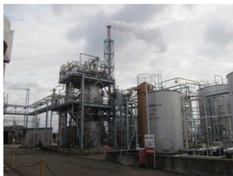
液中燃焼設備
