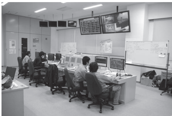
図－５ 中央監視室での運転管理状況
